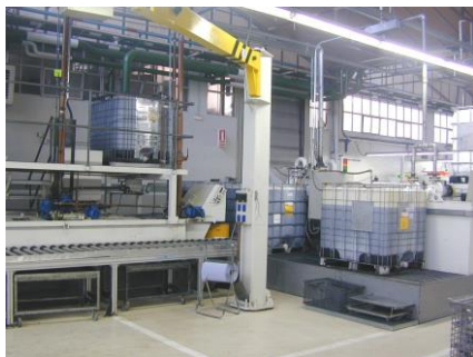
Depósitos de taladrina
